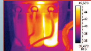
Termografia condensatori, riscaldamento anomalo
