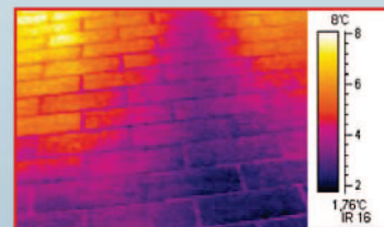
Termografia settore Building infiltrazioni, perdite, ecc, ecc...
